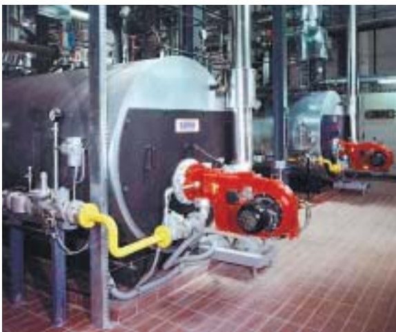
Два паровых котла низкого давления UNIVERSAL U-ND с модулируемыми газовыми горелками
